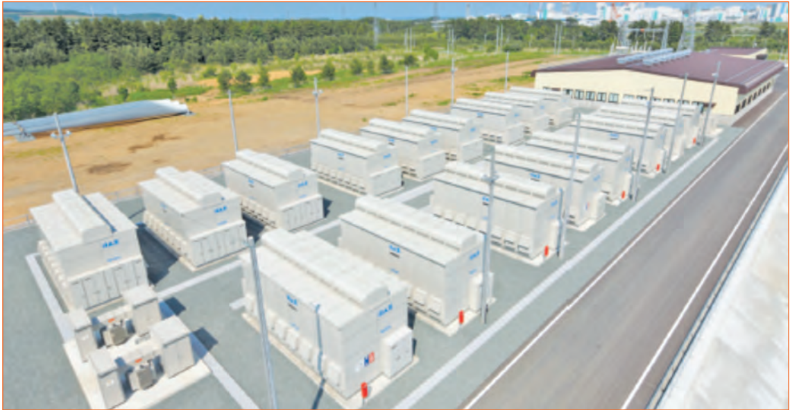
Figura 42: Instalación de almacenamiento de energía para la integración de parques eólicos. Fuente: Energy Storage Association.
