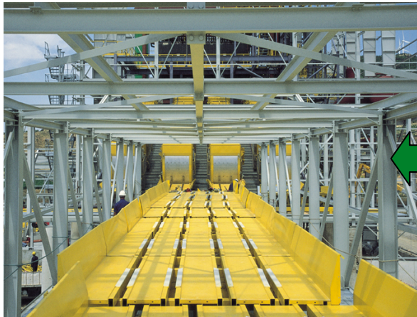
La paja es conducida a la caldera
