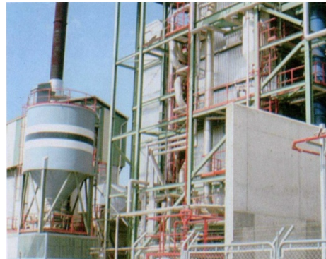
Planta de generación eléctrica con alperujo. Vetejar(Córdoba)12,5MWe
